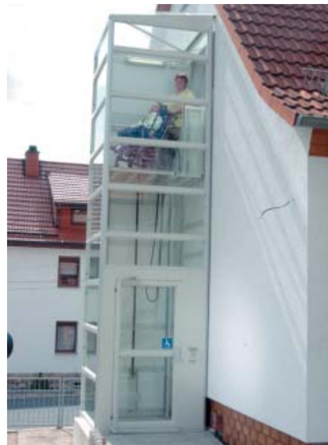
Außenlift am Hausgiebel
